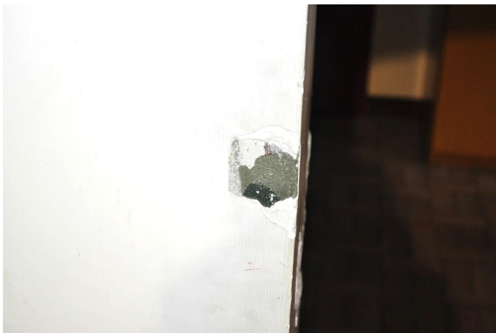
Fot. 2. Ryńsk, kościół pw. NSPJ, otwór drzwiowy prowadzący z prezbiterium do zakrystii. Po przez uraz mechaniczny obecnej warstwy uwidocznił się fragment poprzedniej dekoracji.
