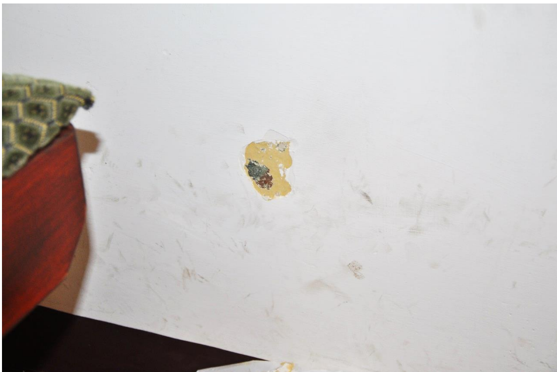
Fot. 3. Kościół pw. NSPJ w Ryńsku, prezbiterium. Po przez uraz mechaniczny na ścianie został uwidoczniiony fragment poprzedniej warstwy w kolorystyce zielono-brązowej. Ściany przybrudzone.
